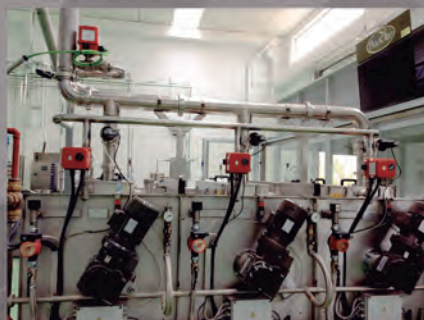
Innovación en CIP de limpieza automática para almazara
