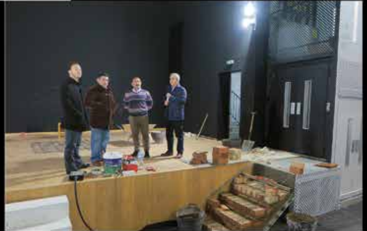
Plataforma elevadora en Auditorio Municipal
