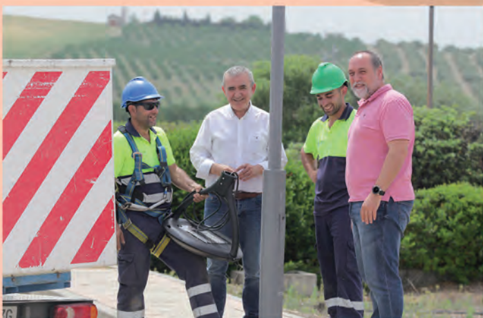
RENOVACIÓN DEL ALUMBRADO DE GEOLIT A TECNOLOGÍA LED
