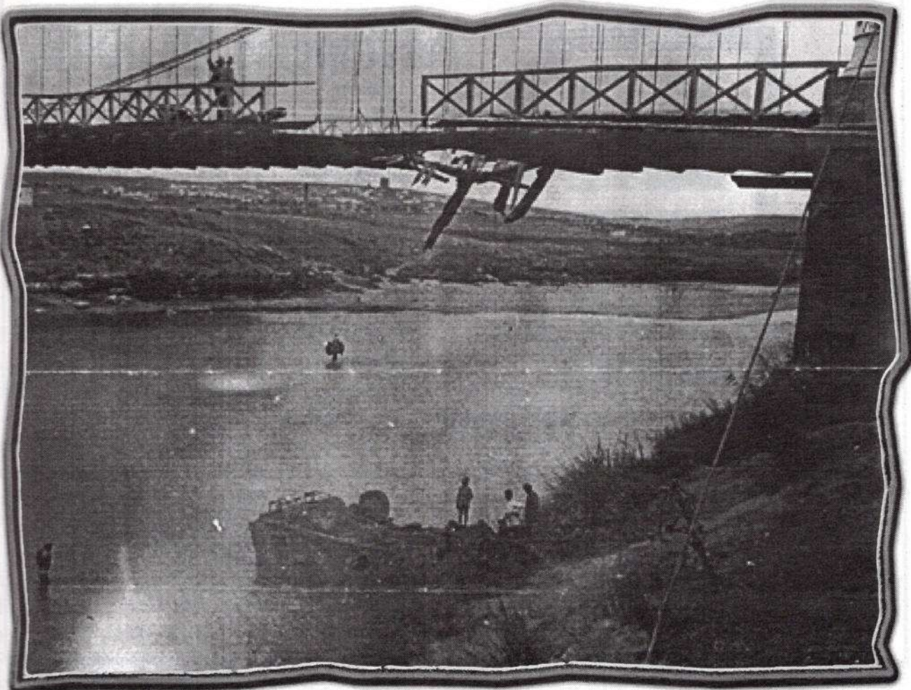
El Puente y el camión después del accidente.
